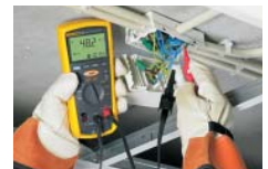
Verdrahtungsprüfung in einem kleinen Verteilerschrank – alles an einem Ort
