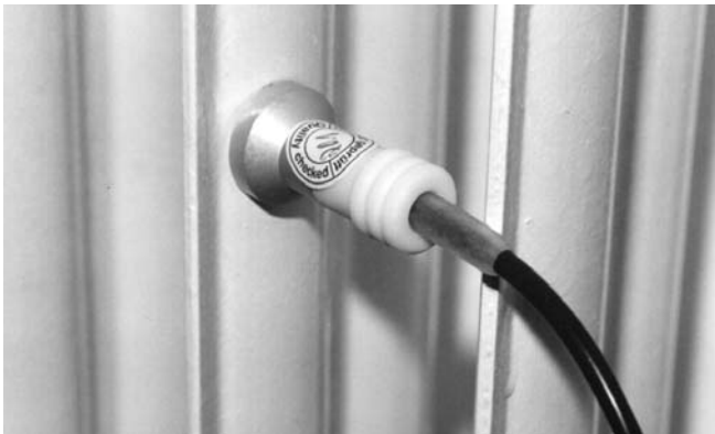
Bild 9: Messung der Oberflächentemperatur eines Heizkörpers mit Magnetfühler 0600.4893
