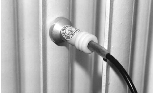
Bild 9: Messung der Oberflächentemperatur eines Heizkörpers mit Magnetfühler 0600.4893
